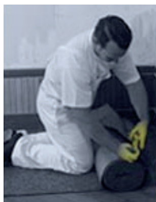
Ausrollen von Abdeckvlies auf trockenen und staubfreien Untergrund & einfaches Zuschneiden auf die passende Länge.
